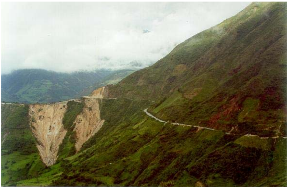
Figura 4.5 Impactos negativos de la construcción de la carretera (Foto: F. Neira).
